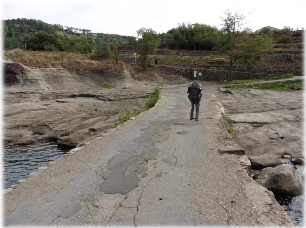
Het dorpje Les Salelles wordt doorkruist door de Chassezac. Na een hevige regenbui staat de brug onder water en wordt de weg afgesloten met een slagboom.
